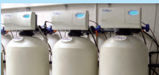
Particolare del pre- trattamento
